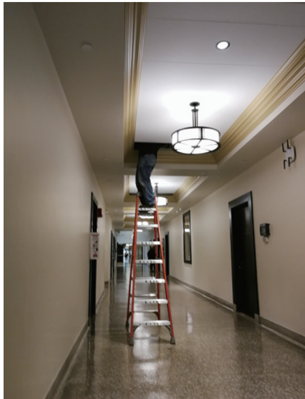
写真1 はしごを用いた作業風景(MIT 居室近くの廊下にて撮影) Photo 1 Maintenance task using ladder
