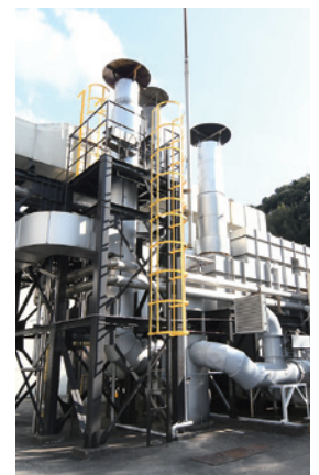
熱源・脱臭装置 燃料転換
